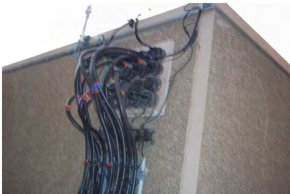
5. Redwood Landfill Cable Entry
